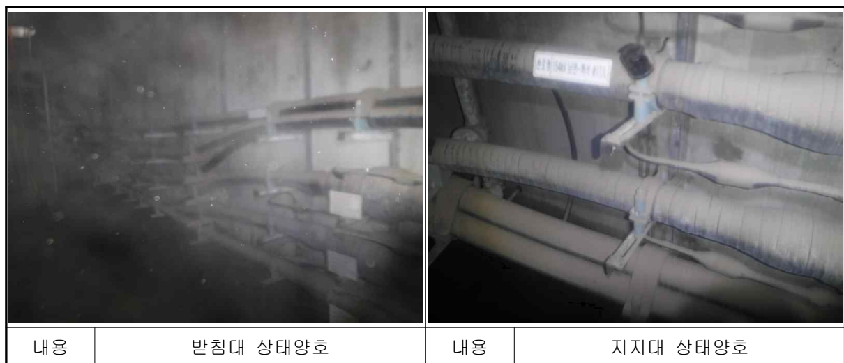
【사진 4.48】 부속 및 부대설비 현황
