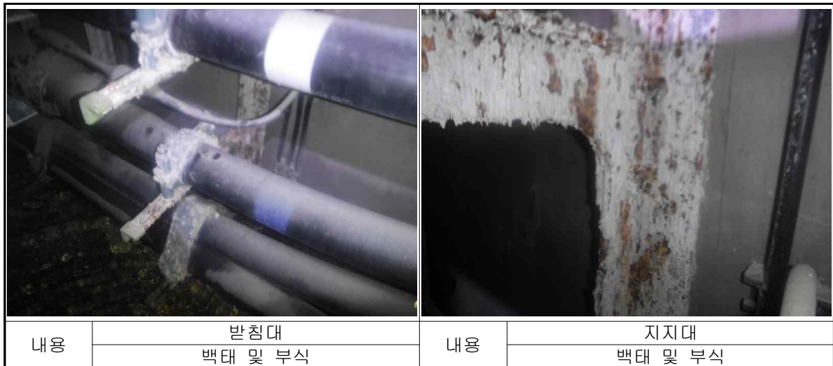
【사진 4.16】 부속 및 부대설비 현황
