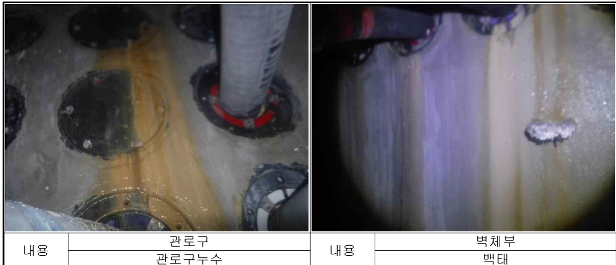
【사진 4.14】 맨홀 내부 주요 손상
