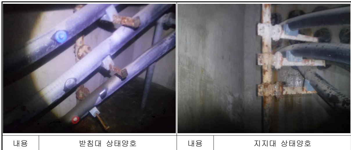
【사진 4.52】 부속 및 부대설비 현황
