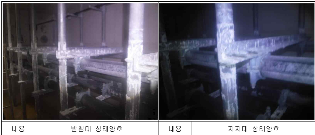
【사진 4.92】 부속 및 부대설비 현황
