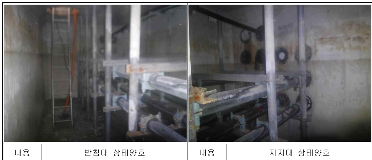
【사진 4.76】 부속 및 부대설비 현황
