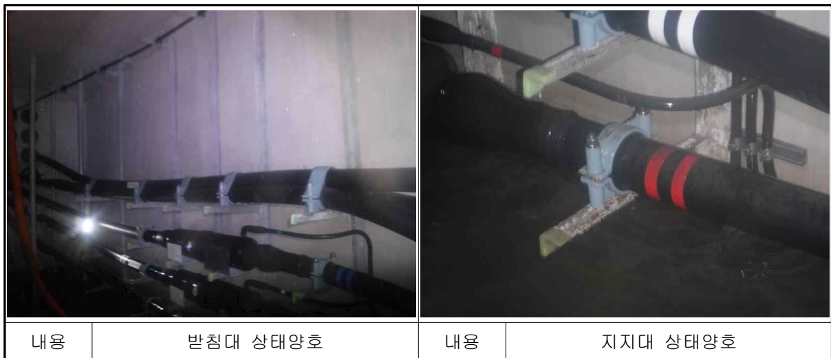
【사진 4.32】 부속 및 부대설비 현황
