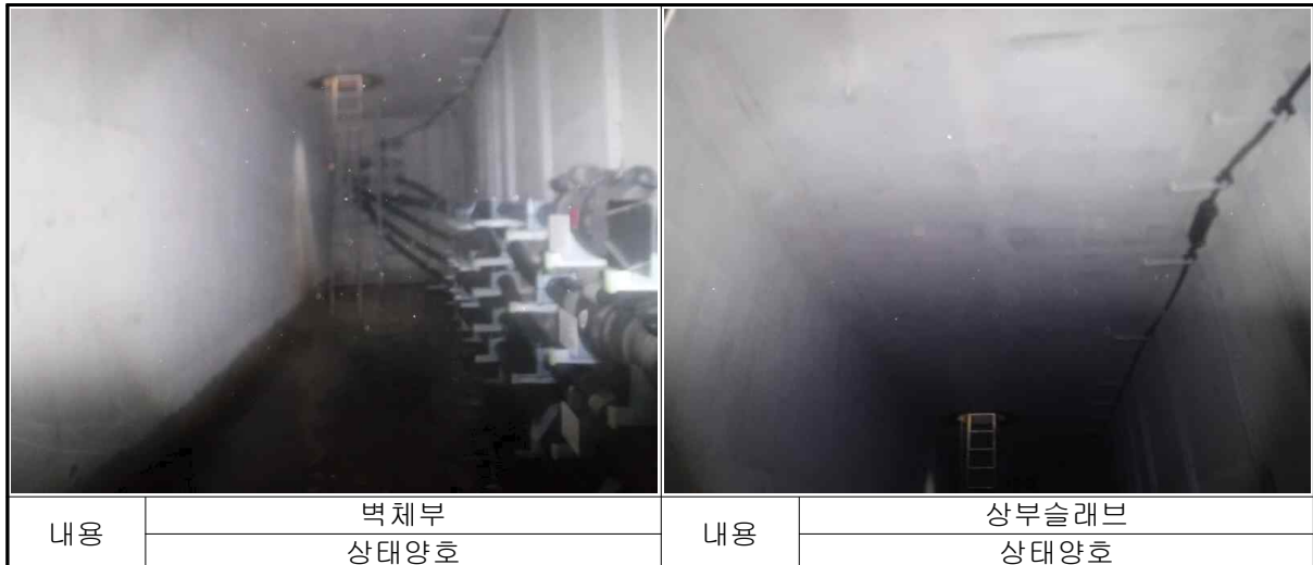
【사진 4.26】 맨홀 내부 주요 손상
