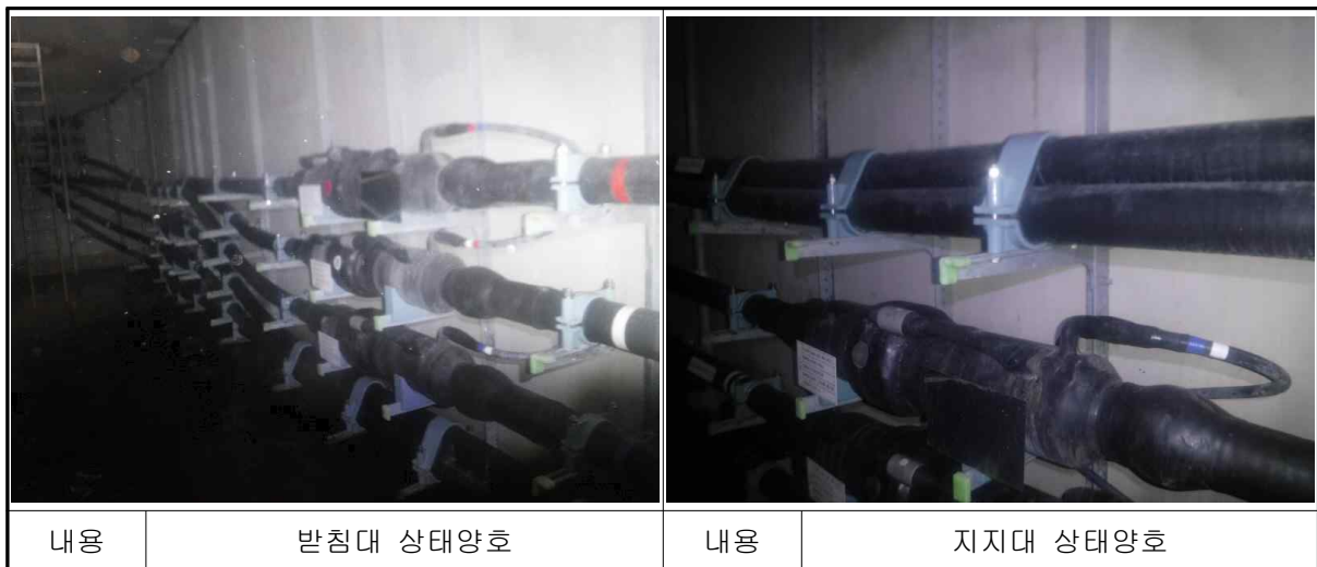
【사진 4.28】 부속 및 부대설비 현황
