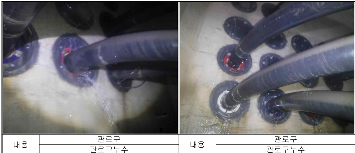
【사진 4.34】 맨홀 내부 주요 손상
