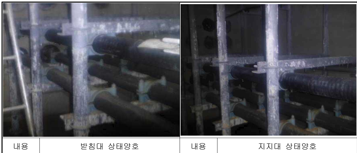
【사진 4.88】 부속 및 부대설비 현황
