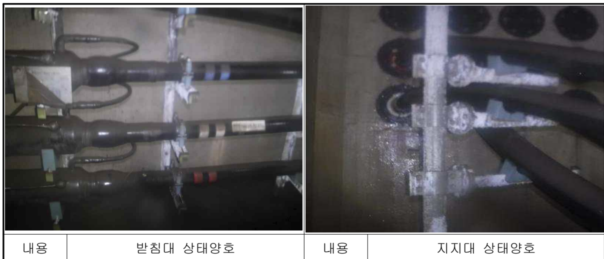
【사진 4.36】 부속 및 부대설비 현황
