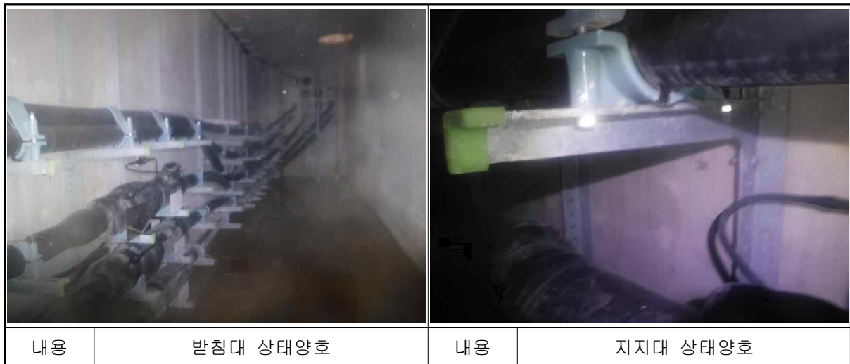
【사진 4.72】 부속 및 부대설비 현황
