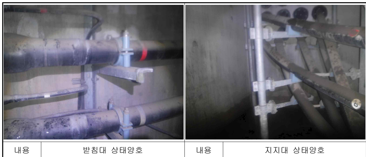
【사진 4.44】 부속 및 부대설비 현황
