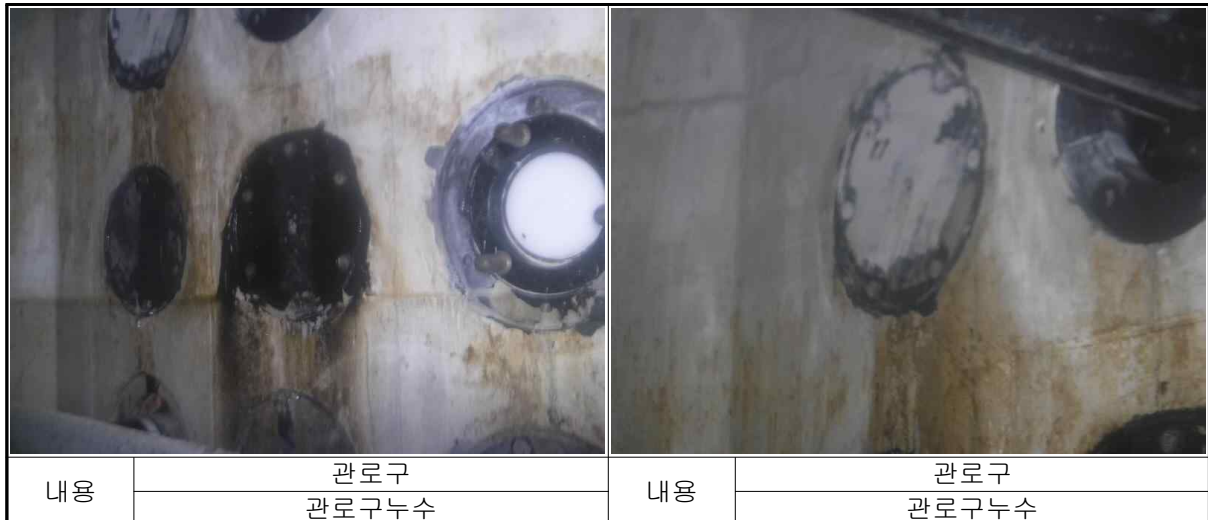
【사진 4.74】 맨홀 내부 주요 손상
