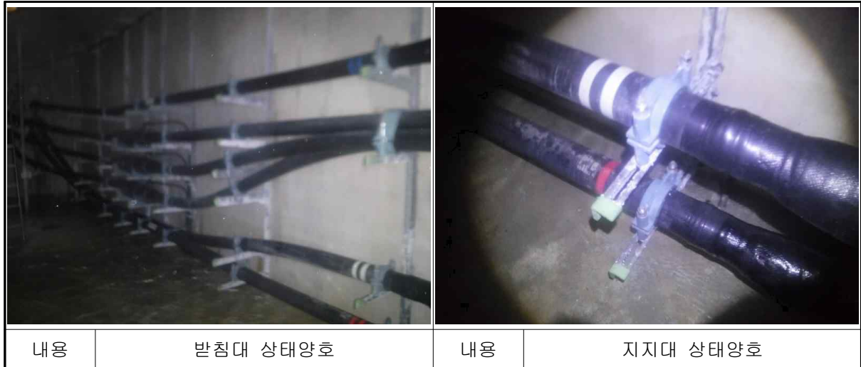
【사진 4.64】 부속 및 부대설비 현황
