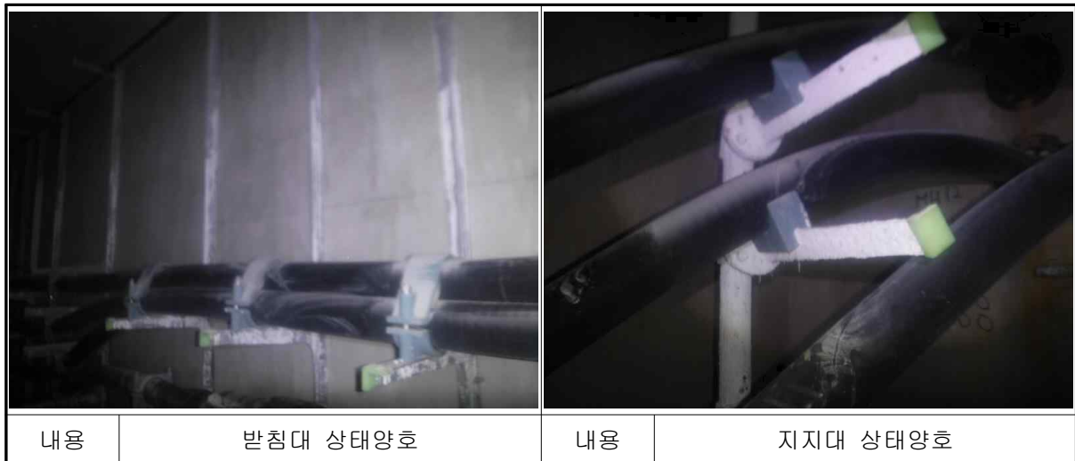
【사진 4.56】 부속 및 부대설비 현황
