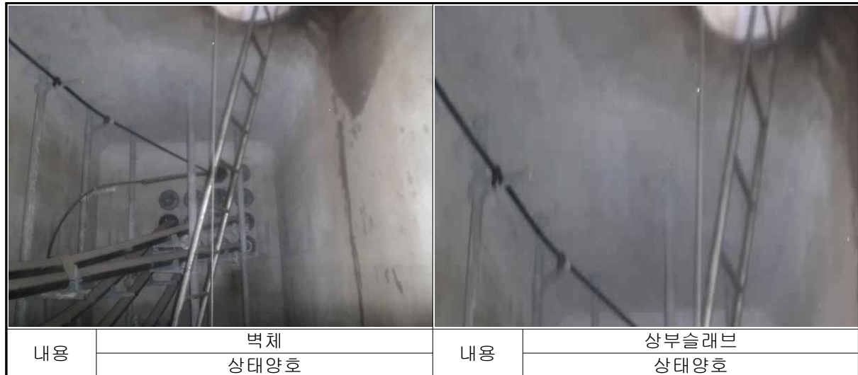
【사진 4.46】 맨홀 내부 주요 손상
