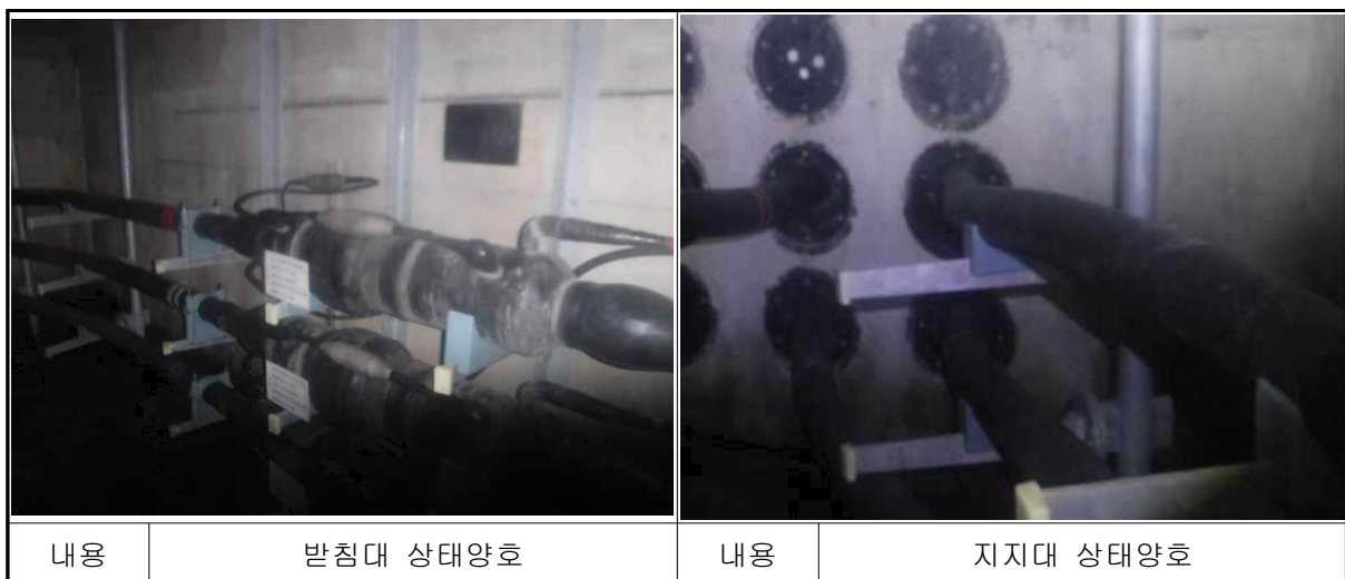
【사진 4.12】 부속 및 부대설비 현황
