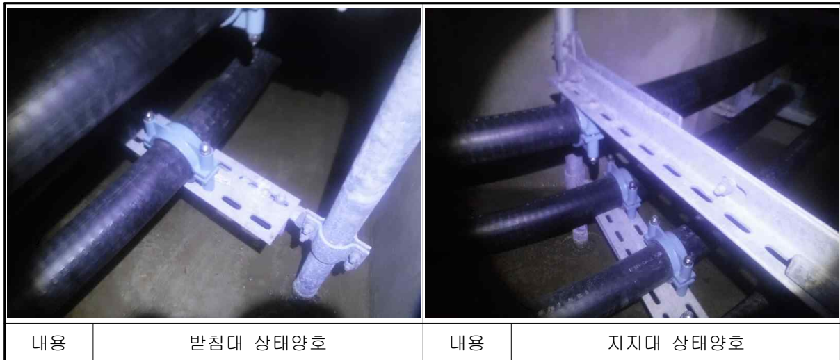
【사진 4.8】 부속 및 부대설비 현황
