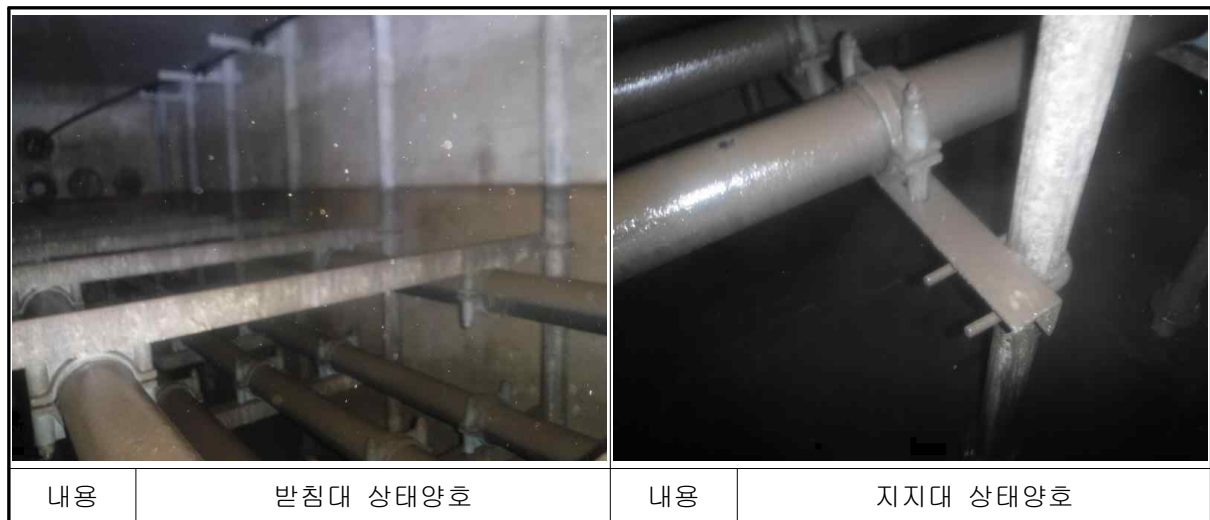
【사진 4.80】 부속 및 부대설비 현황
