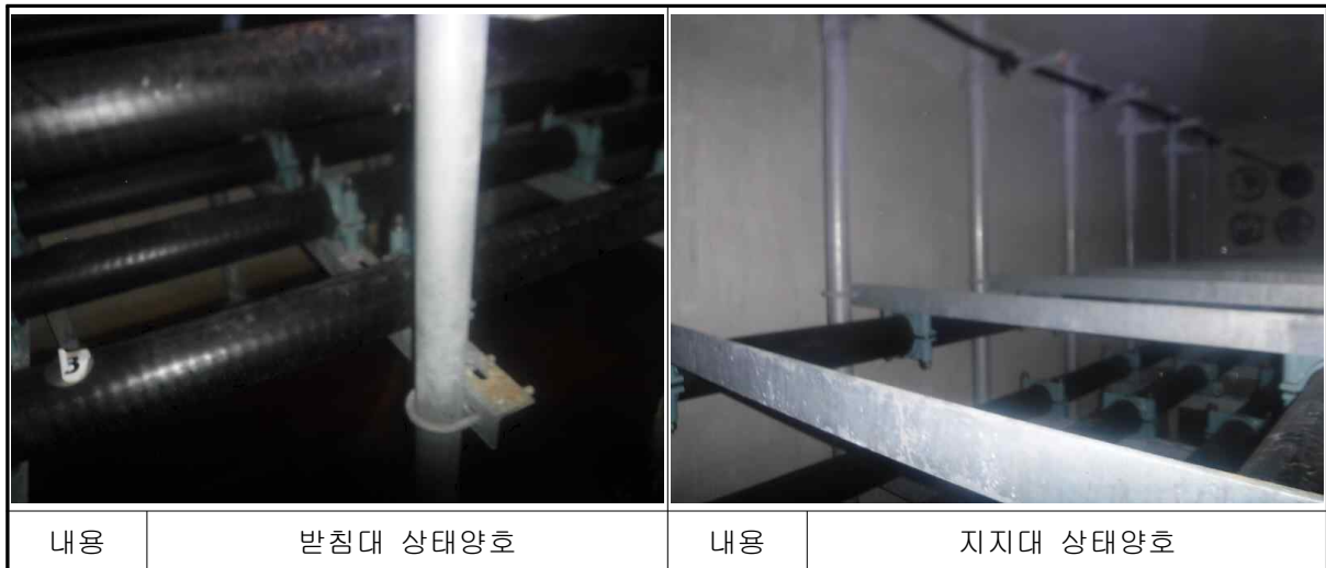
【사진 4.84】 부속 및 부대설비 현황
